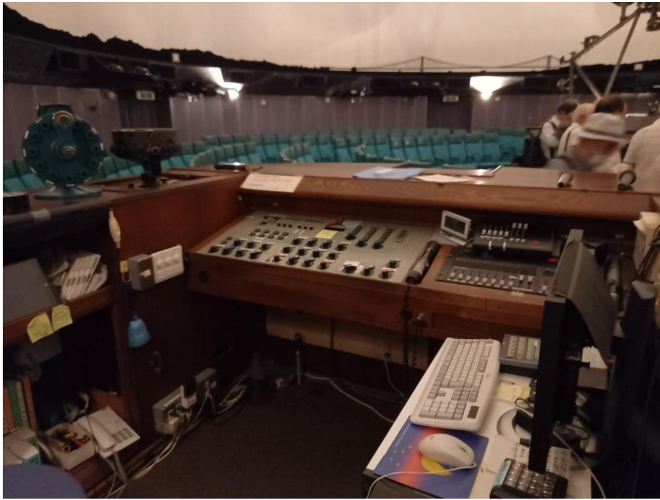
写真3 操作卓の状況
